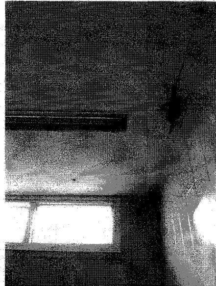
Foto 22: Banheiro da sala do almoxarifado deve-se ter cuidado com o forro de gesso
