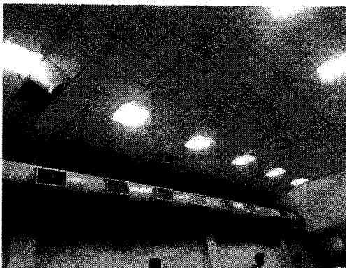
Foto 27: Cobertura do plenário apresenta vazamento, devem ser feita as correções e posteriormente manutenção do forro
