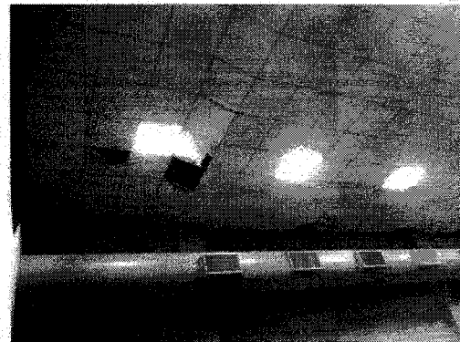
Foto 26: Cobertura do plenário apresenta vazamento, devem ser feita as correções e posteriormente manutenção do forro
