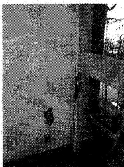
Foto 16: Manchas e deslocamento de revestimento apresentadas nos pés de paredes do pavimento térreo, devido à capilaridade
