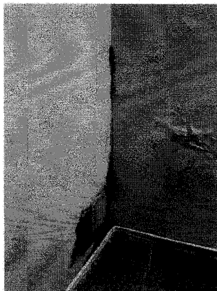
Foto 15: Manchas e mofos apresentadas nos pés de paredes do pavimento térreo, devido à capilaridade
