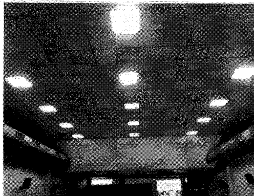
Foto 28: Cobertura do plenário apresenta vazamento, devem ser feita as correções e posteriormente manutenção do forro
