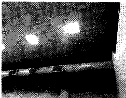
Foto 29: Cobertura do plenário apresenta vazamento, devem ser feita as correções e posteriormente manutenção do forro
